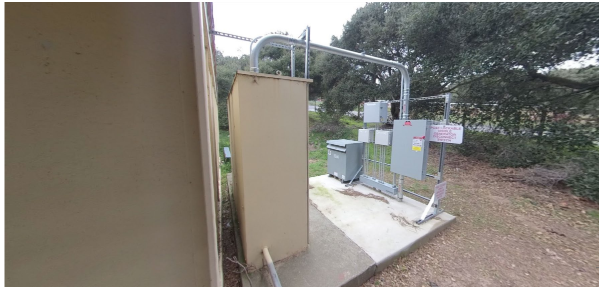
Escuela Primaria Echo Valley – Panel eléctrico sin seguridad
